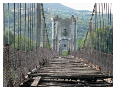
Vue de la chaussée (depuis la tour de la rive gauche) et pile centrale (face sud-est) Phot. I. Havard IVR82_20090700045NUCA
