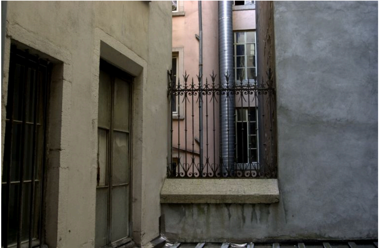
Mur et grille de séparation de la cour du 9, rue Mercière, vue à hauteur du 1er étage
