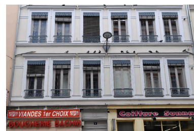
Vue rapprochée de l'élévation sur rue : décor des premier et deuxième étages carrés Phot. Catherine Guégan IVR82_20156901073NUCA
