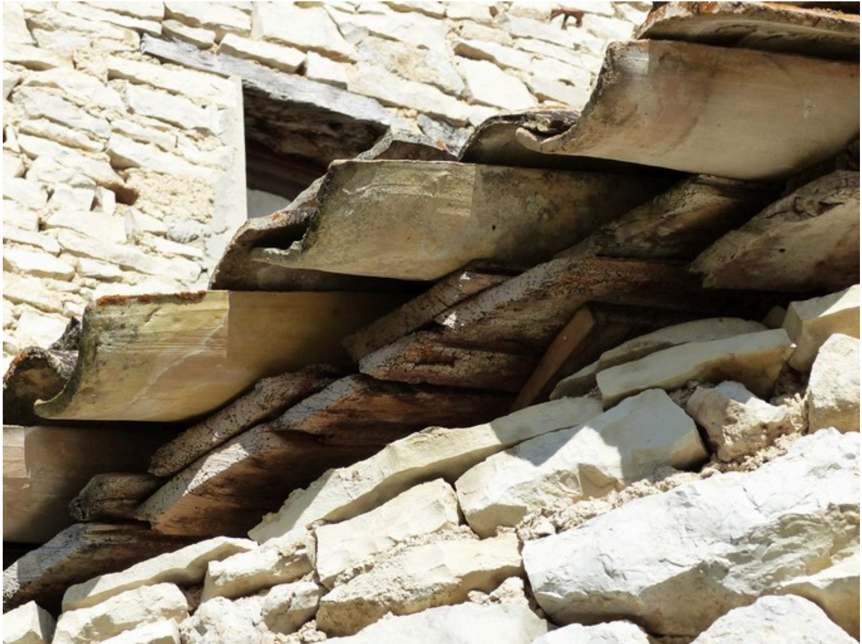
Etable à cochon, plancher de couverture.
