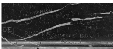
2e tribune sud, balustrade : graffiti, vue d'ensemble Phot. Eric Dessert IVR82_20136901758NUCA
