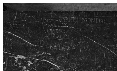
3e tribune sud, balustrade : graffiti, détail Phot. Eric Dessert IVR82_20136901754NUCA
