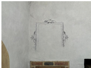
4e chapelle du bas-côté nord : vestiges (restitution?) de décor peint Phot. Thierry Leroy IVR82_20136902795NUCA
