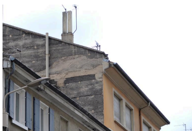
Vue du pignon sud, mâchefer et béton apparents Phot. Magali Delavenne IVR84_20176901432NUCA
