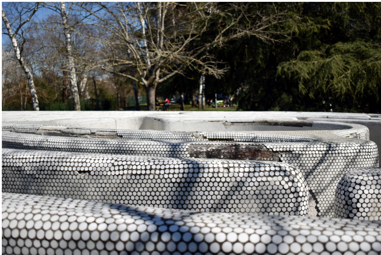
Détail des altérations : éclats, perte de matière
