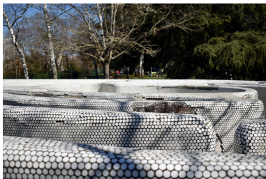
Détail des altérations : éclats, perte de matière
