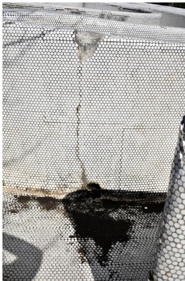
Détail des altérations : fissures, perte de matière, micro-organismes.
