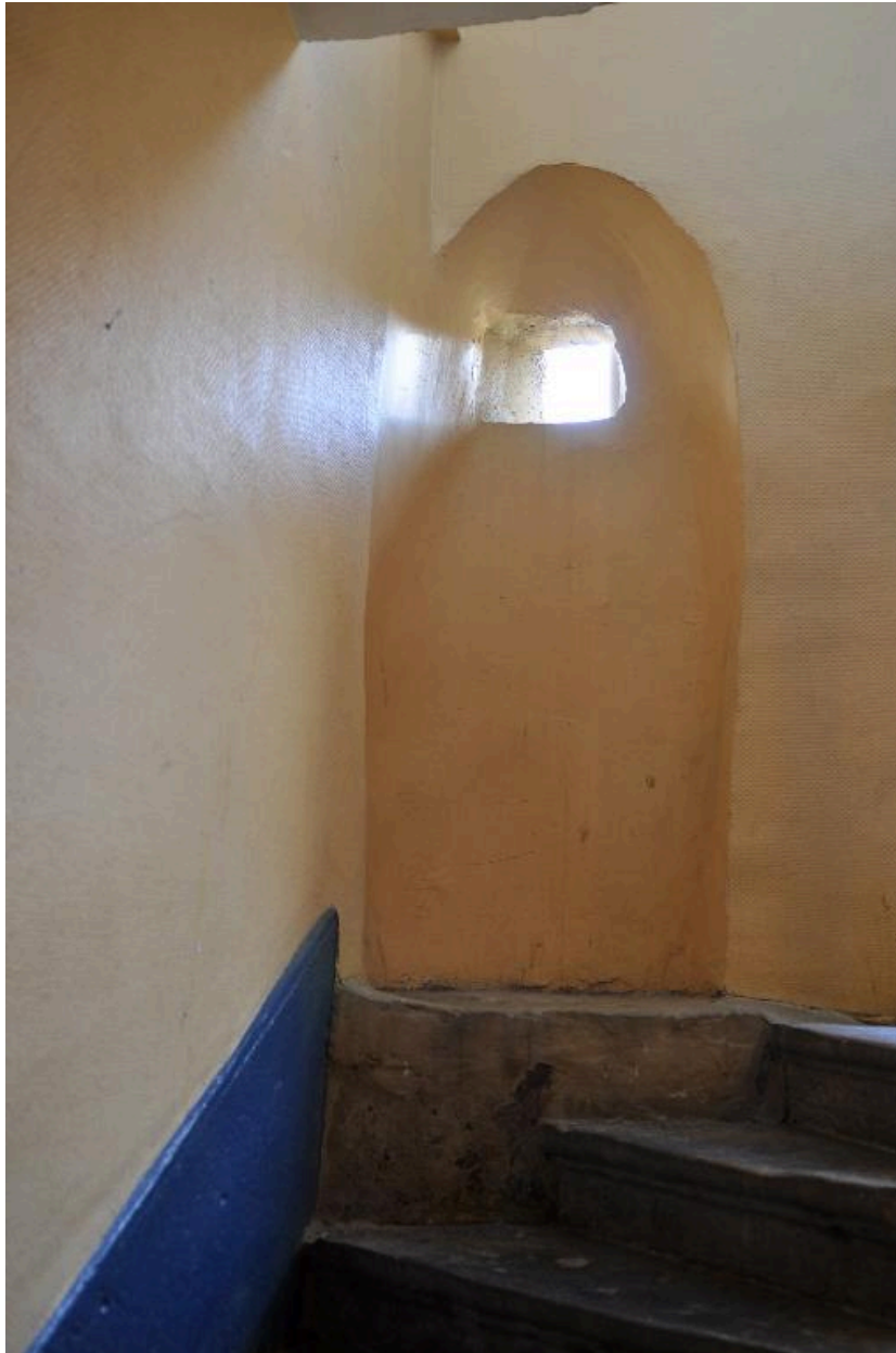
Vue intérieure : niche ménagée dans l'angle de la cage d'escalier, au deuxième étage
