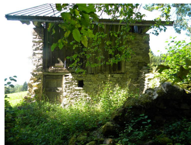
Vue d'une partie éffondrée en façade sud d'une grange (2008 E7 949). Phot. Jérôme Daviet IVR82_20157401646NUCA
