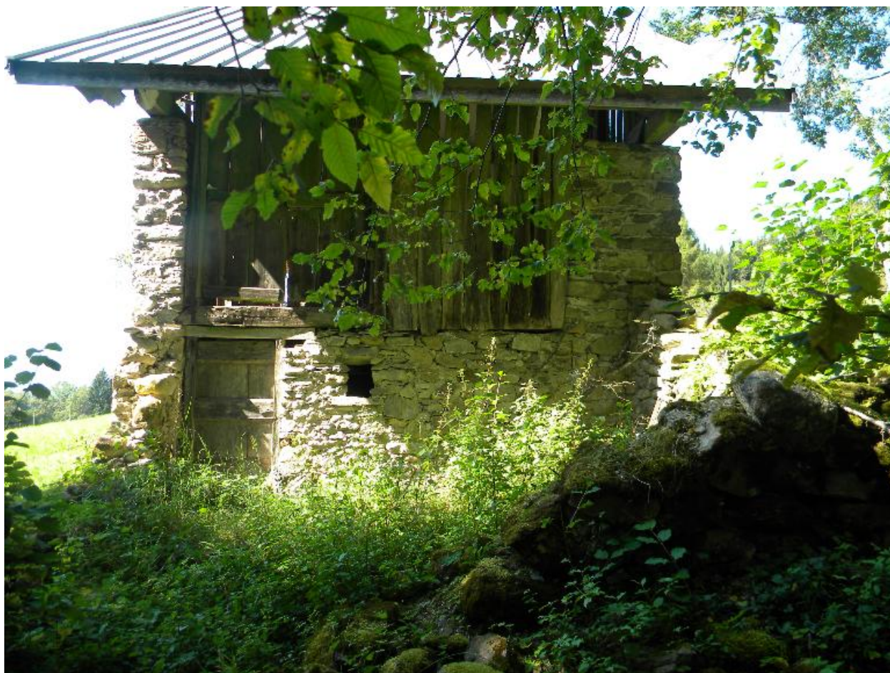
Vue d'une partie éffondrée en façade sud d'une grange (2008 E7 949).
