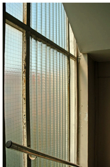
Détail de la baie vitrée éclairant la cage d'escalier Phot. Maryannick Chalabi IVR82_20066903055NUCA
