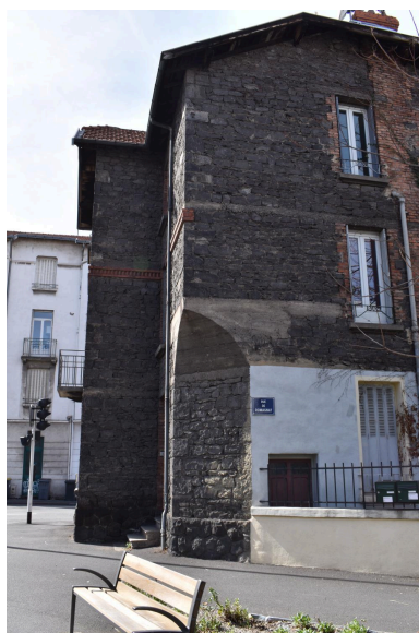
Elévation latérale sur la rue de Romagnat, aménagement de l'angle entre-coupe Phot. Félicie Fougère IVR84_20246301215NUCA
