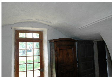
Vue du décor mouluré sous les reins de la voûte Phot. Geneviève Jourdan IVR82_20092600488NUCA
