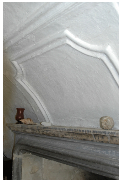
Détail de la cheminée et du décor mouluré Phot. Geneviève Jourdan IVR82_20092600487NUCA
