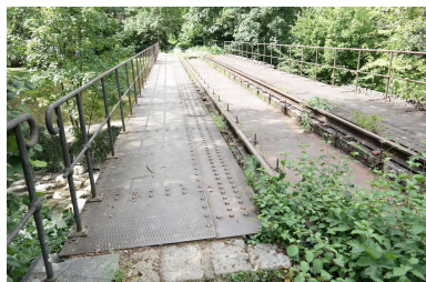
Ancien pont ferroviaire de Cran, vue de la chaussée Phot. Pascale Renard IVR84_20207403850NUCA
