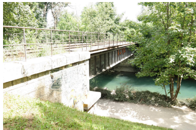
Ancien pont ferroviaire de Cran, vue de la face amont Phot. Pascale Renard IVR84_20207403847NUCA
