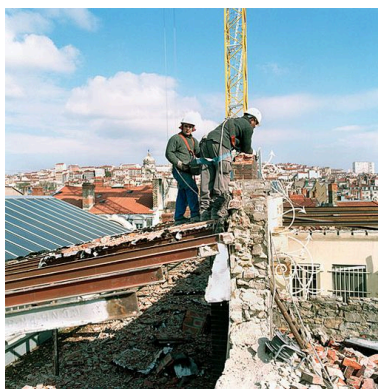
Toit en cours de démolition, détail du mur mitoyen séparant l'immeuble de celui de la banque Phot. Didier Gourbin IVR82_20046901545XE
