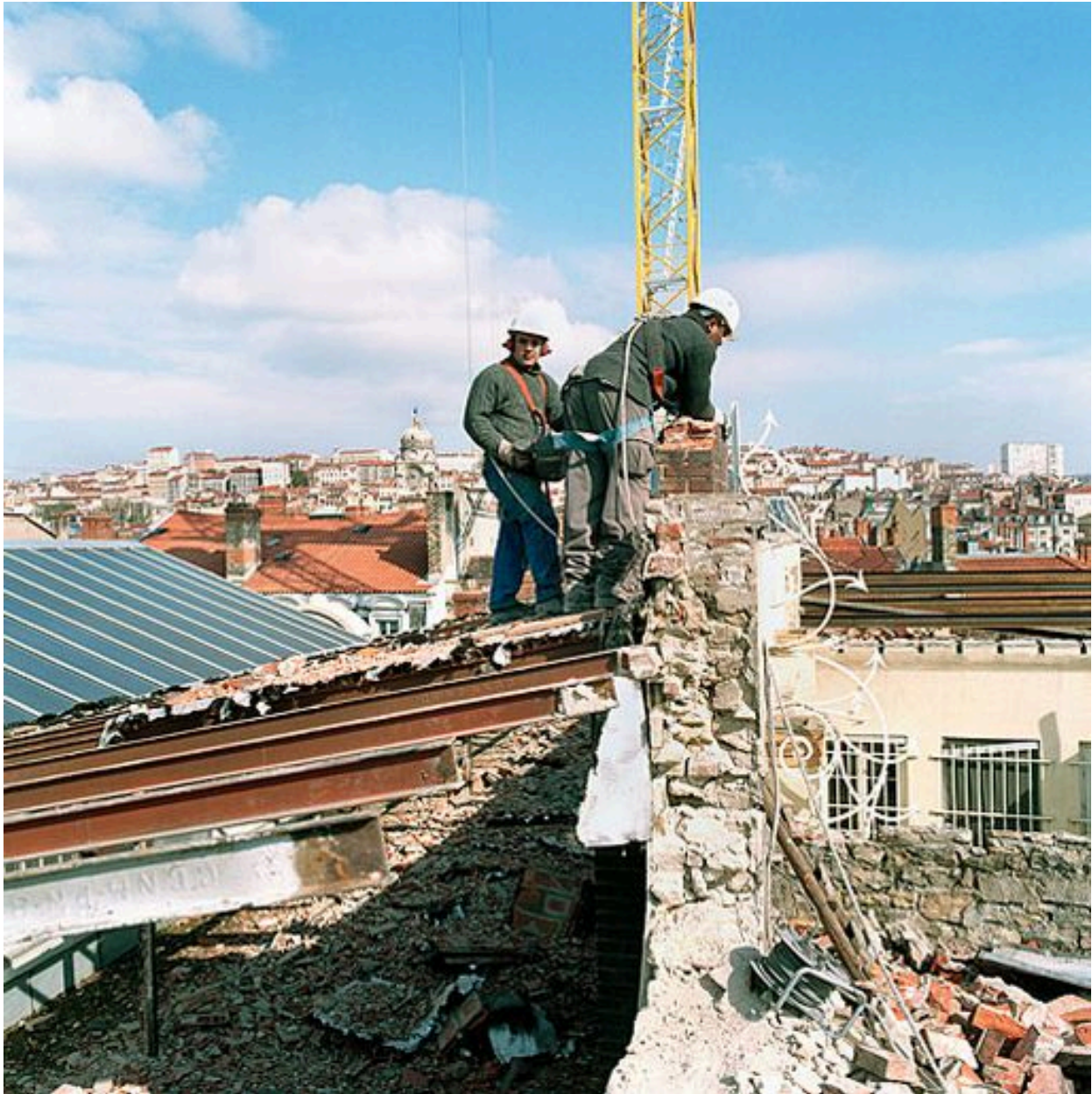
Toit en cours de démolition, détail du mur mitoyen séparant l'immeuble de celui de la banque
