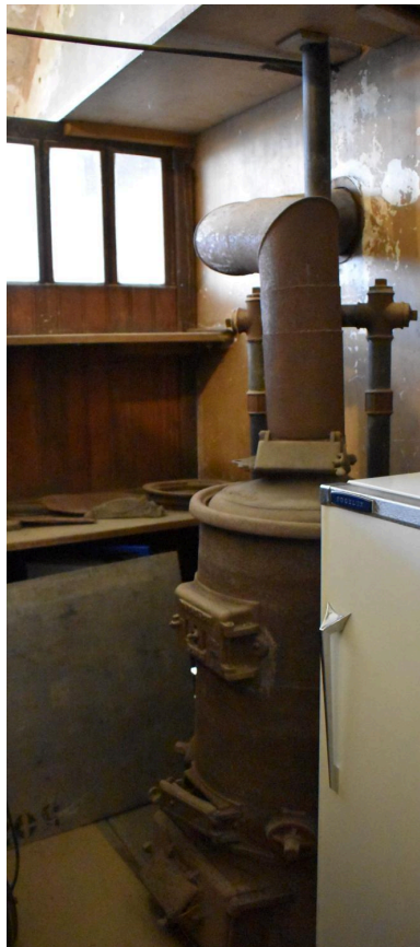
Vue de la chaudière Phot. Maryse Durin-Tercelin IVR84_20226300612NUC4A
