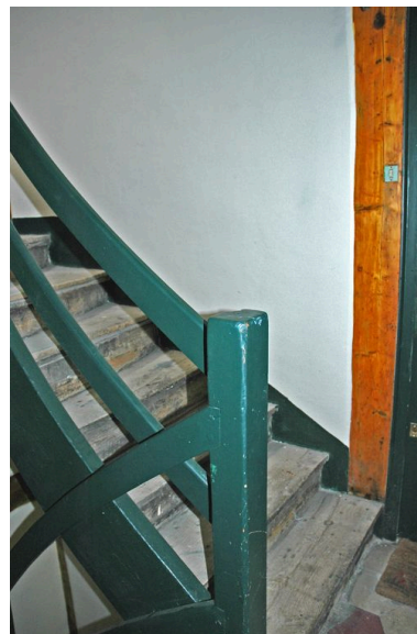
Départ de la seconde volée de l'escalier balancé en bois Phot. Maryannick Chalabi IVR82_20026901213NUCA
