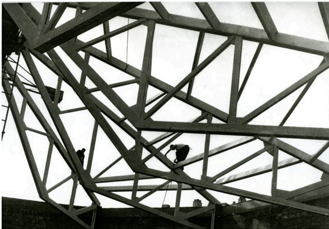
Vue de la charpente lors de la construction, depuis le dessous. Photogr. Paul Curtelin (Arch. privées)
