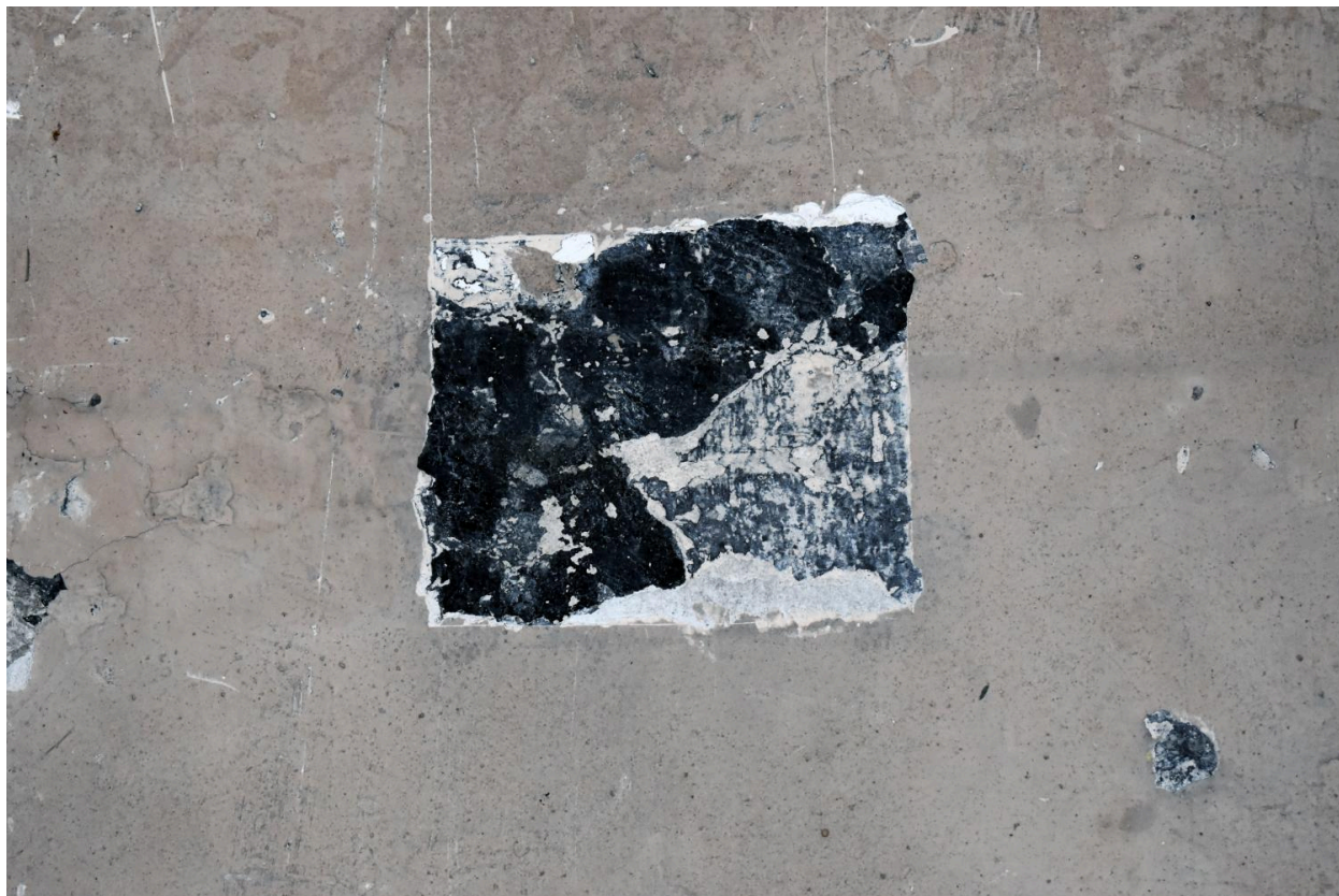
Chapelle de la Vierge, mur ouest : décor peint sous-jacent
