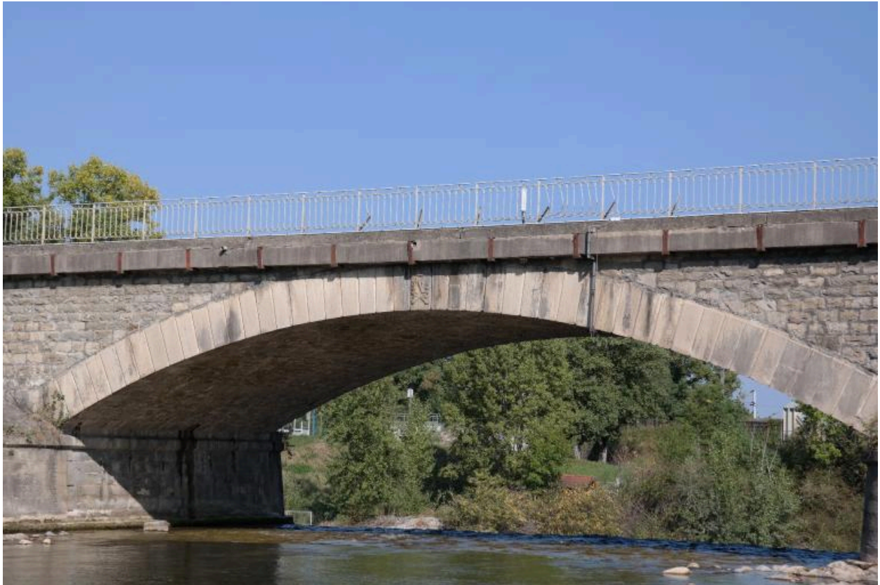
Pont de Dranse, détail de l'arche centrale en face amont, avec l'écusson "N" de Napoléon III et l'échelle de mesure de l'eau sur la pile vers la rive gauche
