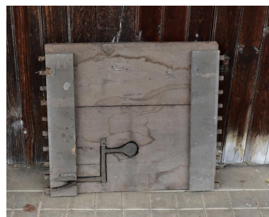
mécanisme de chasse d'eau incomplet Phot. Maryse Durin-Tercelin IVR84_20226300976NUC4A
