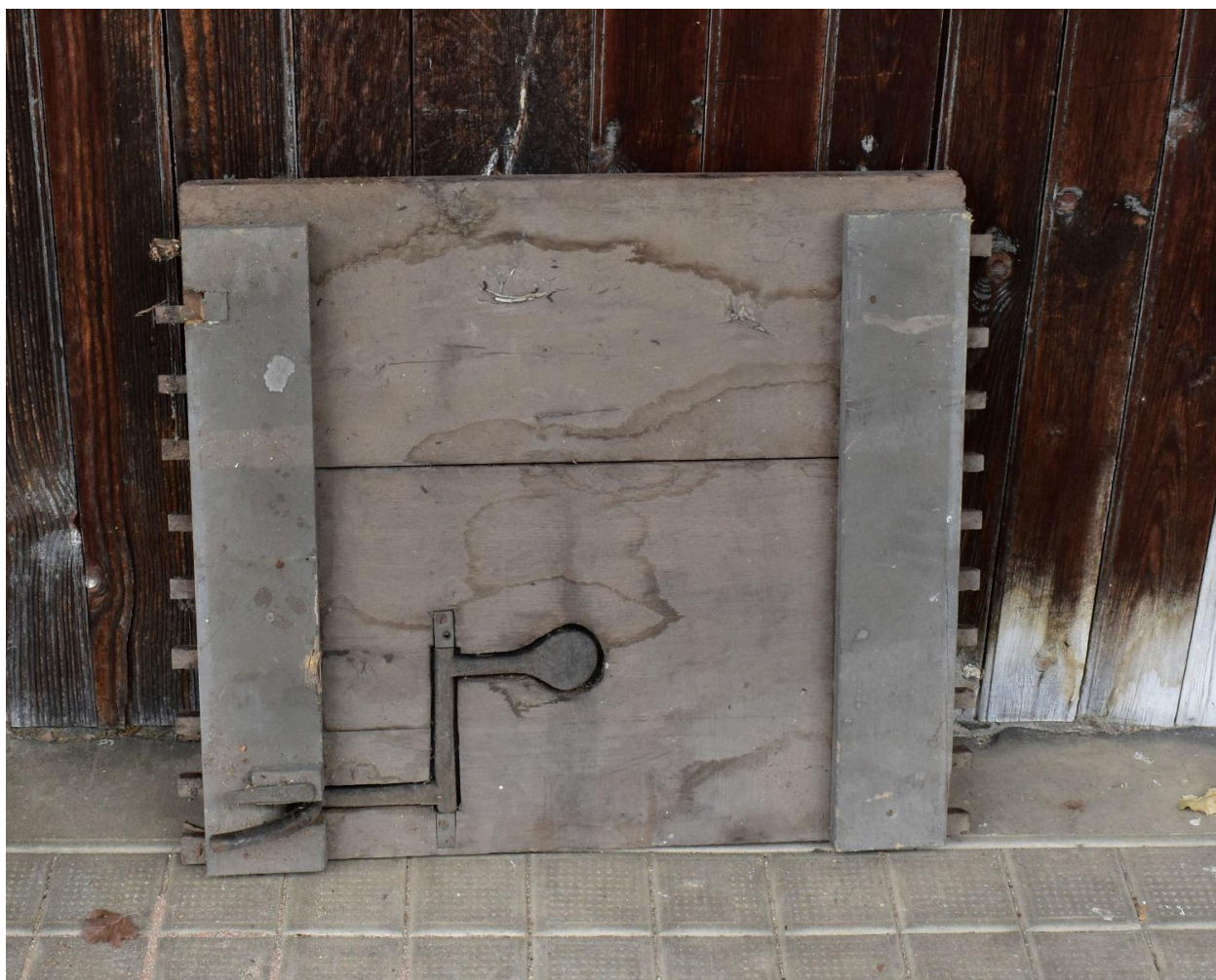
mécanisme de chasse d'eau incomplet
