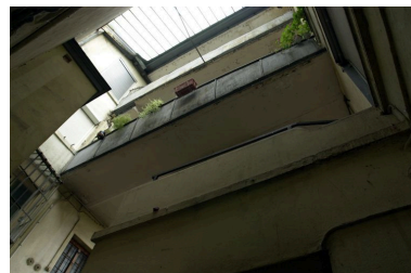
Vue de la verrière au-dessus de la cour Phot. Chantal Archer-Galéa IVR82_20016901211NUCA
