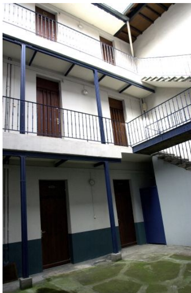
La coursière de l'immeuble de la cour, élévation est Phot. Maryannick Chalabi IVR82_20016901806NUCA
