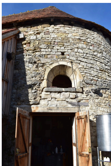
Vestige d'une baie en plein cintre de l'abside, au sud-est. Phot. Maryse Durin-Tercelin IVR84_20250300515NUCA
