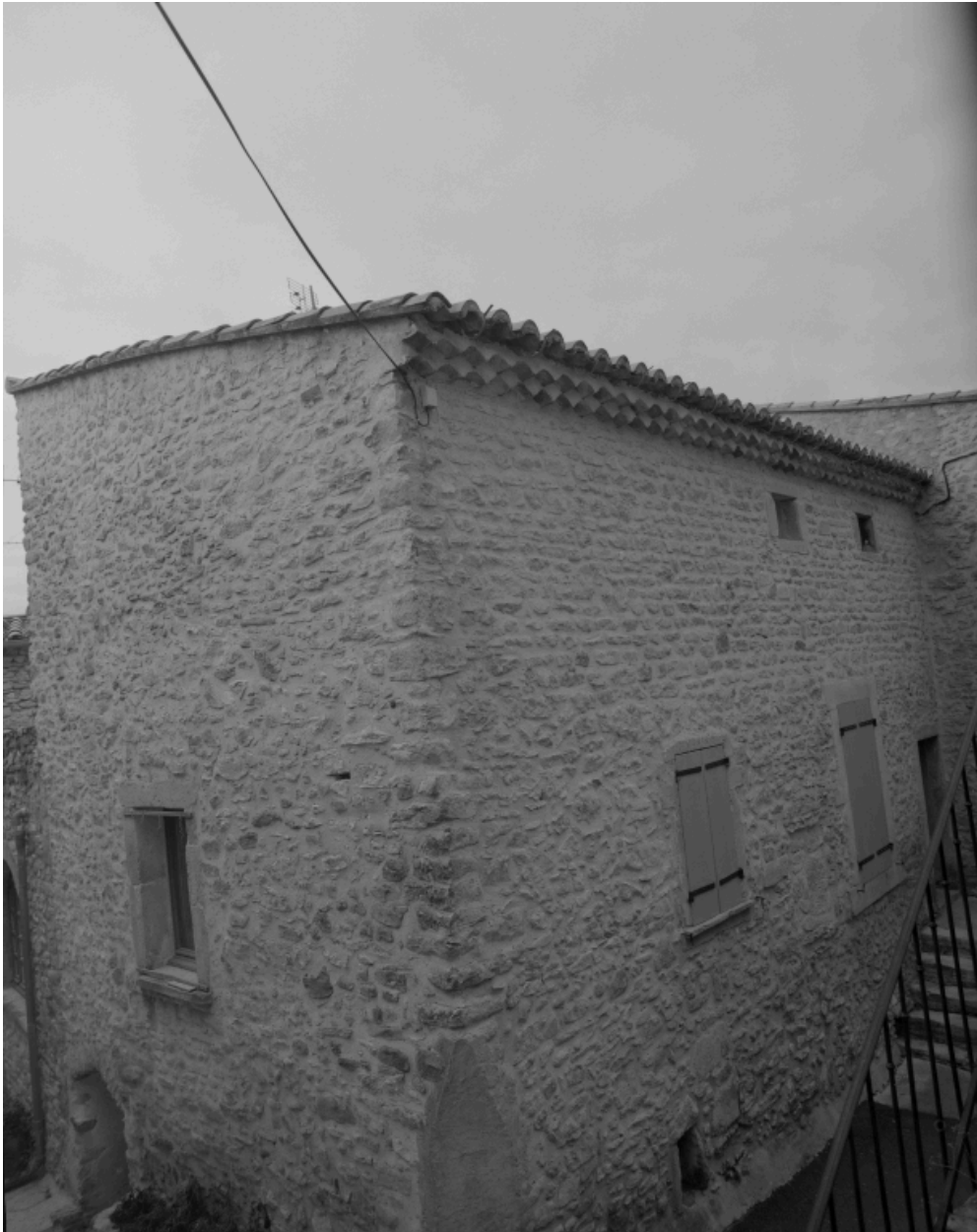
Le Pègue, Village. Maison (B3 662), vue de trois quarts, élévation latérale sur la rue Traversière.
