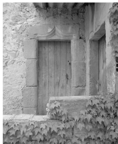
Rousset-les-Vignes, rue des Dauphins (RD 538) - rue du Valat. Maison (C1 108), détail de l'élévation postérieure : porte à linteau orné d'une double accolade.
