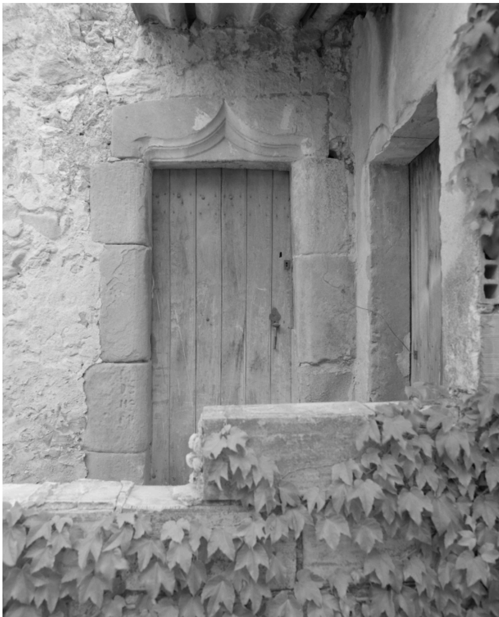
Rousset-les-Vignes, rue des Dauphins (RD 538) - rue du Valat. Maison (C1 108), détail de l'élévation postérieure : porte à linteau orné d'une double accolade.
