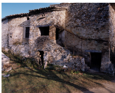
Rousset-les-Vignes, les Guilles. Ferme, vue du logis ancien. Phot. Alain Franchella IVR82_19982600986XA
