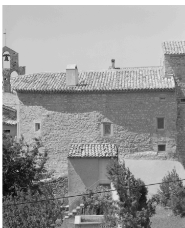
Rousset-les-Vignes, rue des Alics. Maison (C1 14), élévation est, vue partielle. Phot. Alain Franchella IVR82_19982600459X
