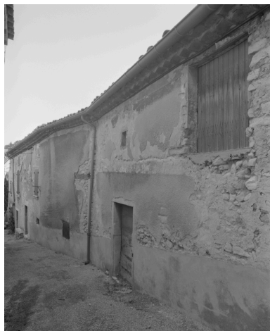
Rousset-les-Vignes, rue des Dauphins (RD 538). Maison (C1 139), élévation latérale sur la rue du Bourg et, plus bas, façade de la maison C1 1145.
