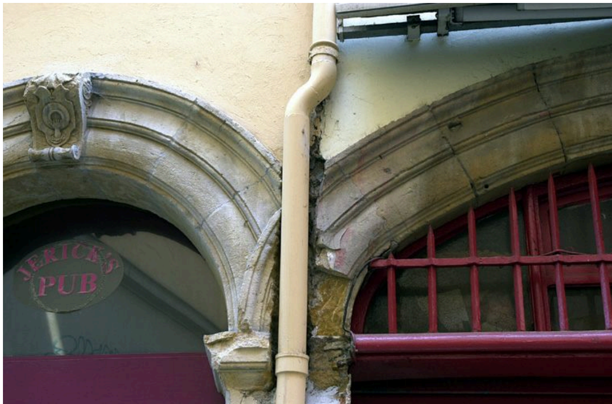
Elévation rue de la Monnaie, rez-de-chaussée : mouluration des arcs bûchée pour permettre le passage d'une gouttière
