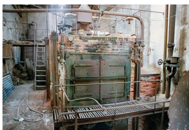
Détail chaudière Phot. Nadine Halitim-Dubois IVR82_20046902795ZE
