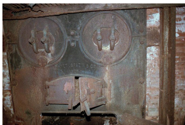
Détail chaudière Phot. Nadine Halitim-Dubois IVR82_20046902786ZE
