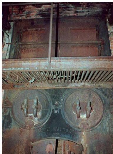
Détail chaudière Phot. Nadine Halitim-Dubois IVR82_20046902785ZE
