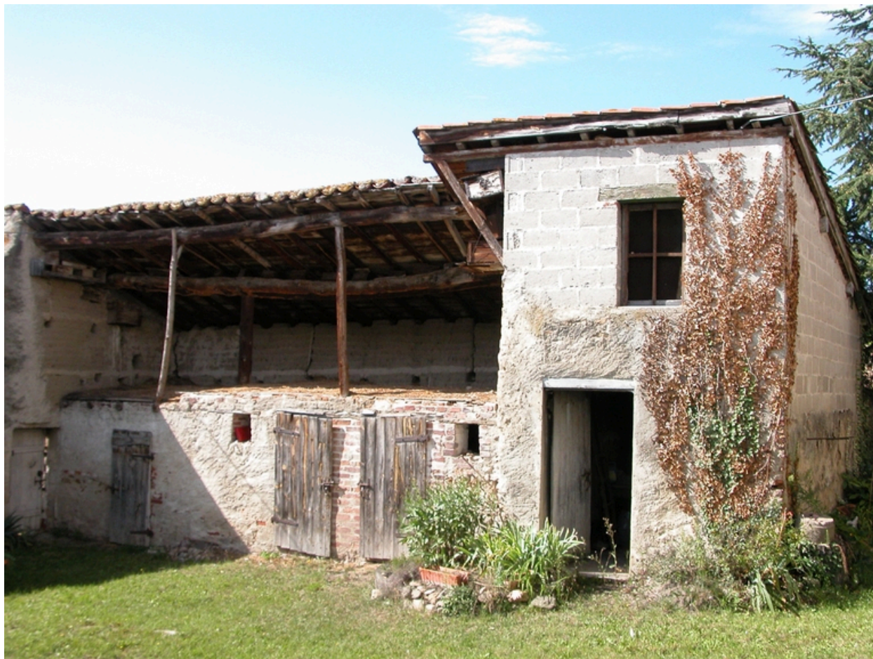
Vue de la porcherie et de la chaudière.
