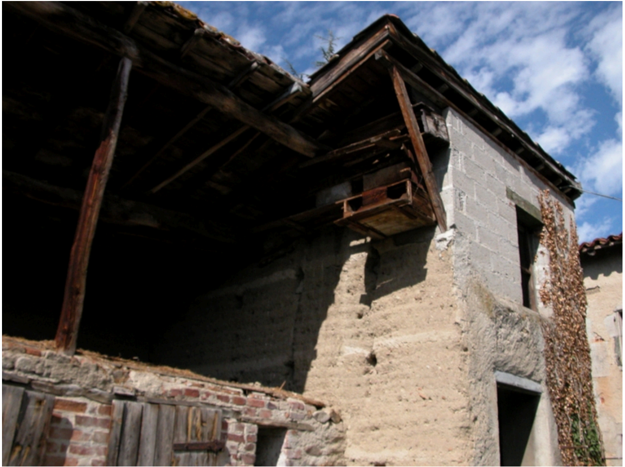
Détail des casiers à pigeons (fuies) sous le toit de la chaudière.
