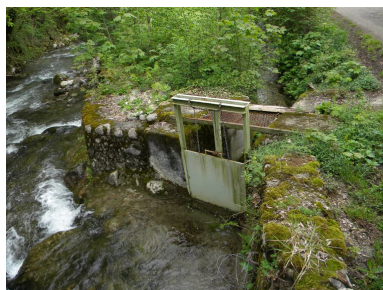
Vue de la prise d'eau dans l'Ire. Phot. Jérôme Daviet IVR82_20107402909NUCA
