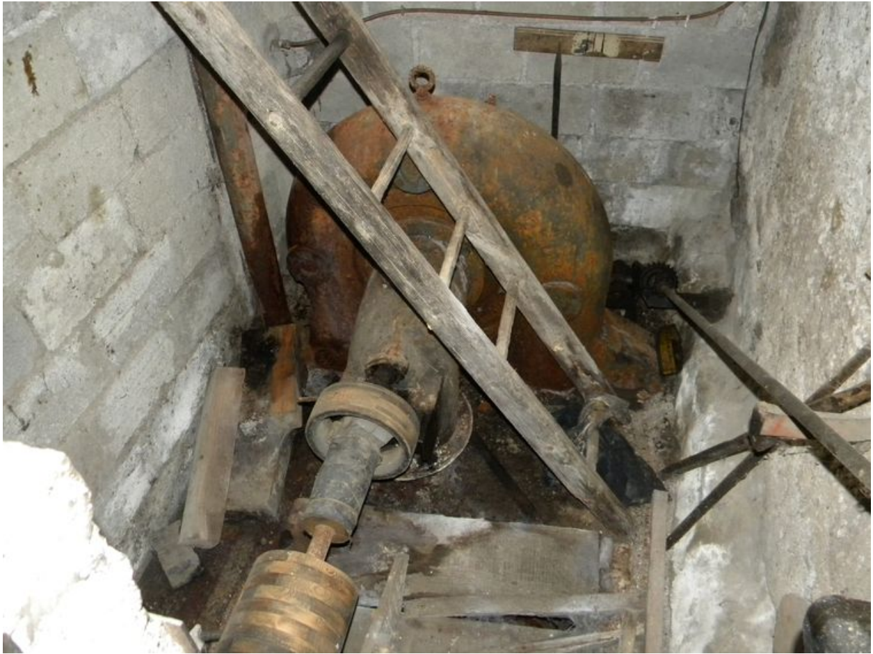
Vue de la turbine hydroélectrique.
