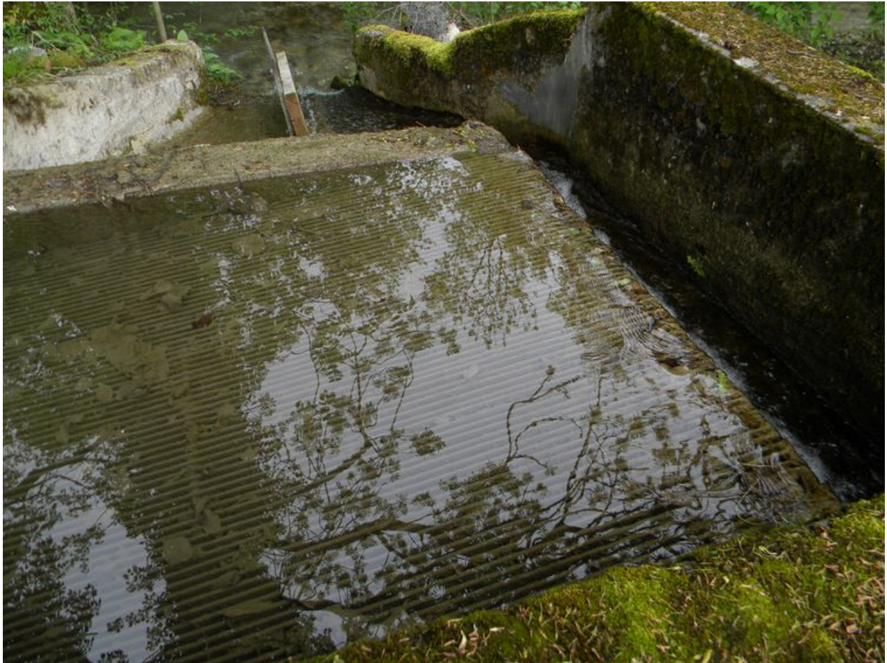
Vue de la grille formant la chute, et du trop-plein retournant dans l'Ire.
