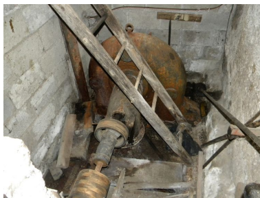
Vue de la turbine hydroélectrique. Phot. Jérôme Daviet IVR82_20107402905NUCA
