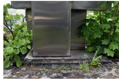
Détail de la base ; socle envahi par les mousses et lichens Phot. Catherine Guégan IVR84_20254300185NUCA
