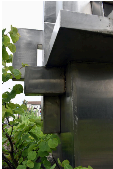
Détail des corrosions et salissures Phot. Catherine Guégan IVR84_20254300184NUCA
