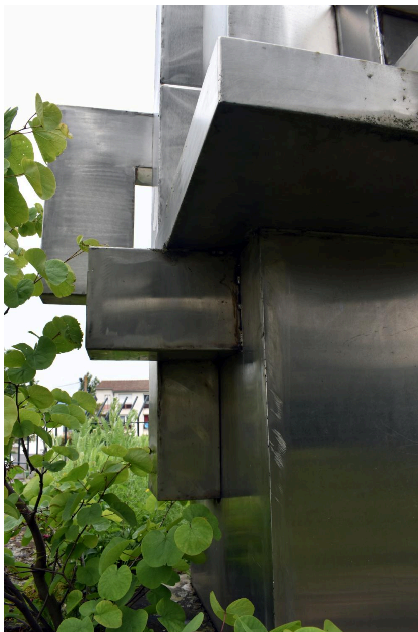
Détail des corrosions et salissures
