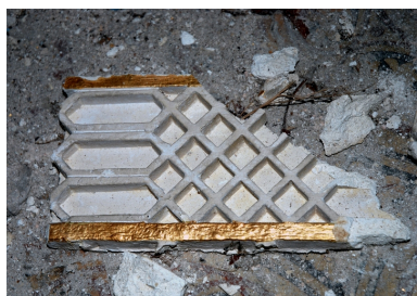
Plaque de stuc détachée de la coupole Phot. Catherine Guégan IVR82_20123800151NUCA
