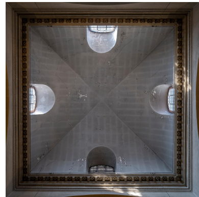
Vue de l'intrados du dôme depuis la croisée du transept Phot. Michel Pérès IVR84_20256900229NUCA
