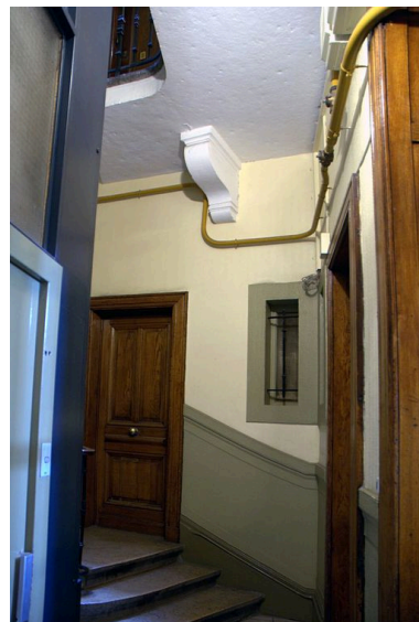
Vue de l'entrée de la loge de gardien Phot. Maryannick Chalabi IVR82_20116901512NUCA
