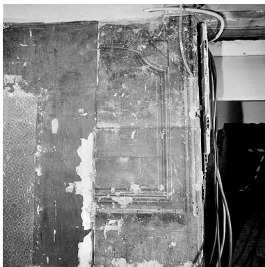
Corps de bâtiment sur rue, premier étage, pièce sur cour, détail du décor mural Phot. Martial Couderette IVR82_20016900184X
