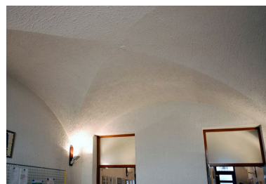
Rez-de-chaussée, ancienne boutique sur rue, actuellement bureau, voûte en croisée d'arrêtes Phot. Catherine Guégan IVR82_20096900749NUCA
