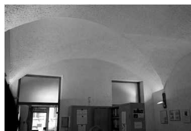
Rez-de-chaussée, ancienne boutique sur cour, actuellement bureau, voûte en croisée d'arêtes. Phot. Catherine Guégan IVR82_20096900752NUC
