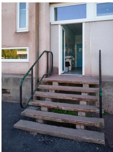
Degré d'accès aux sanitaires depuis la cour ouest du lycée : le béton armé des marches, endommagé, laisse apparaître l'armature métallique. Les rampes d'appui en tubes métalliques sont d'origine.
