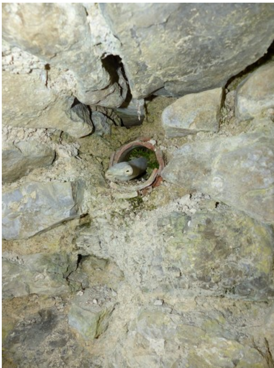
Canalisation d'amenée d'eau.
