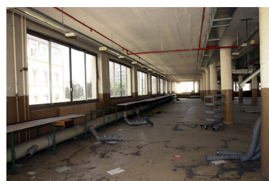
Vue des ateliers du 4eme étage Phot. Nadine Halitim-Dubois IVR82_20036901916NUCA
