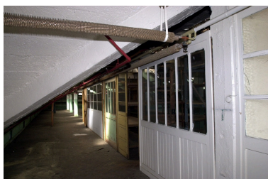
Système de chauffage dans la sous-pente Phot. Nadine Halitim-Dubois IVR82_20036901933NUCA
