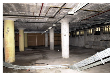
Atelier en sous-sol Phot. Nadine Halitim-Dubois IVR82_20036901948NUCA
