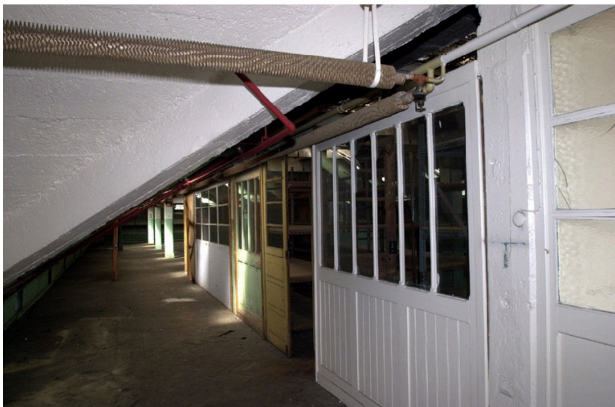
Système de chauffage dans la sous-pente
