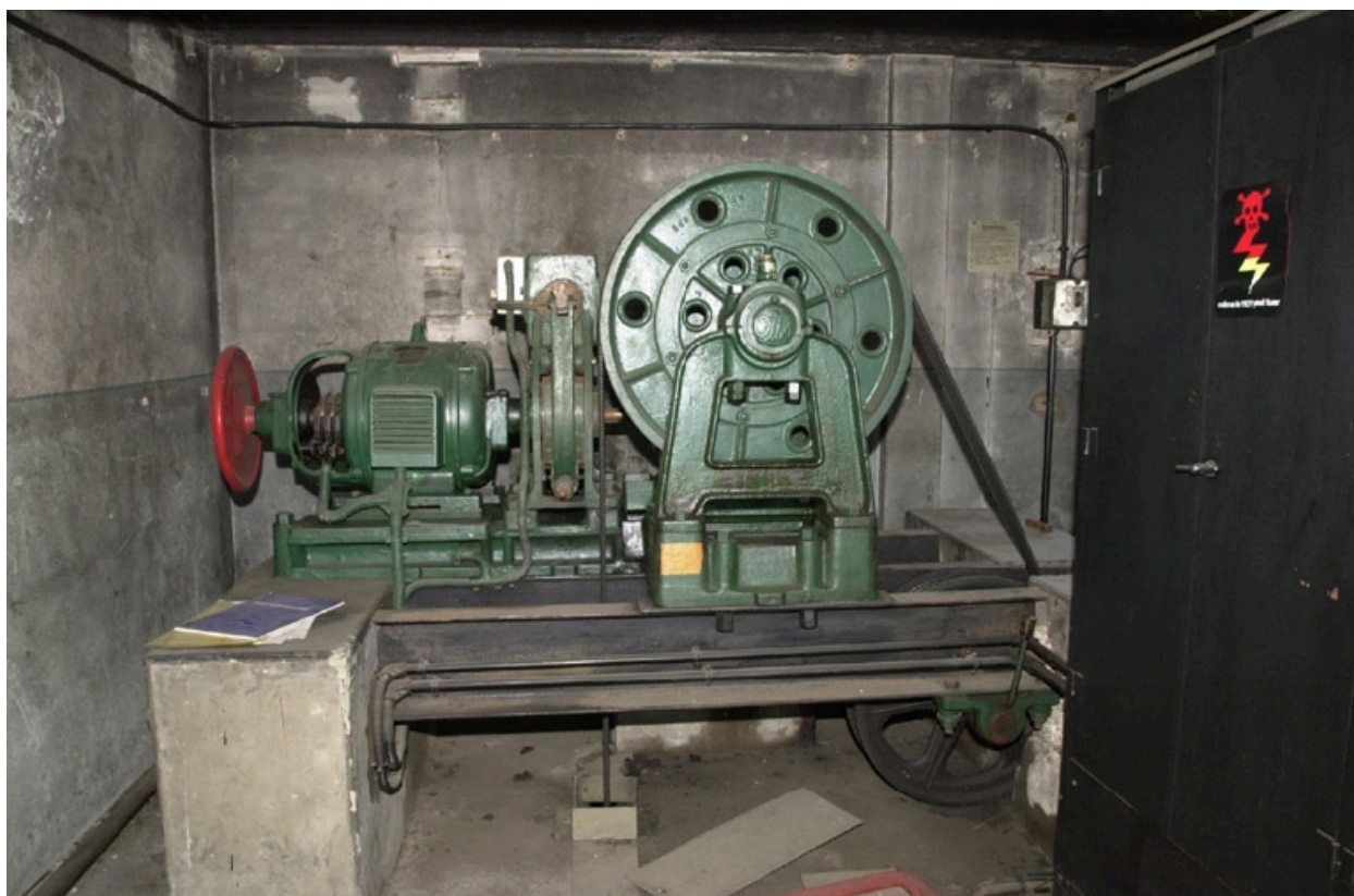
Moteur du monte-charge
