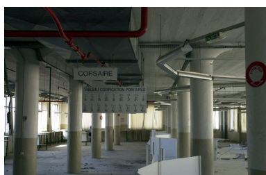
Même atelier, appareillage technique : système d'aération Phot. Nadine Halitim-Dubois IVR82_20036901946NUCA
