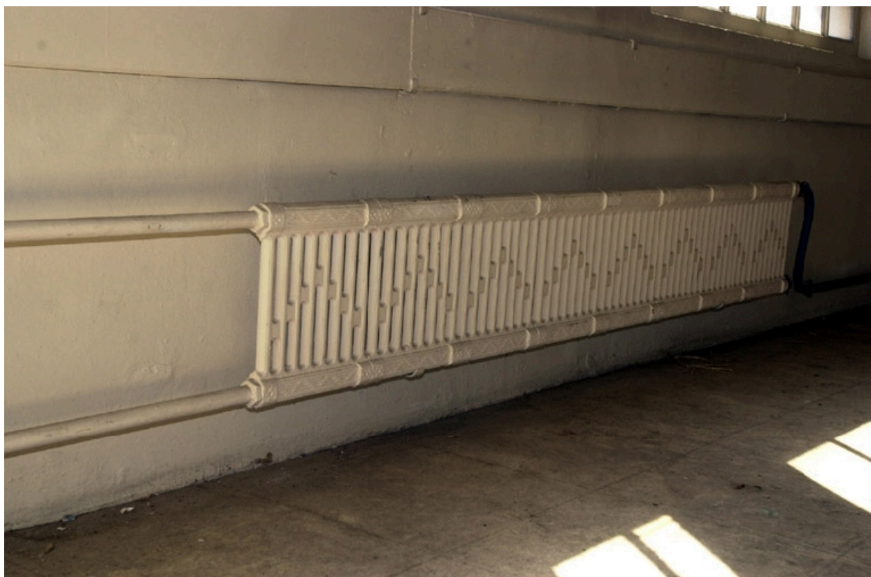
Système de chauffage central : radiateur
