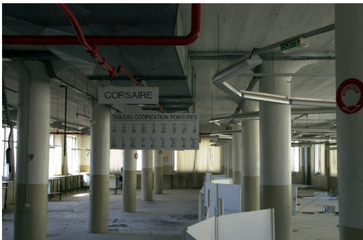
Même atelier, appareillage technique : système d'aération
