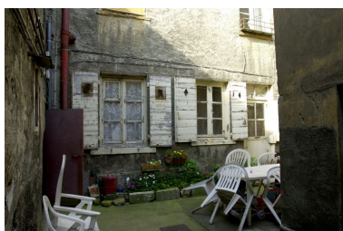
Elévation est de la 1ère maison en milieu de parcelle Phot. Maryannick Chalabi IVR82_20106903481NUCA
