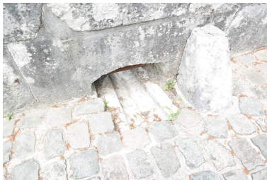
Pont Coppet, détail d'une gargouille depuis la chaussée Phot. Pascale Renard IVR84_20207403158NUCA
