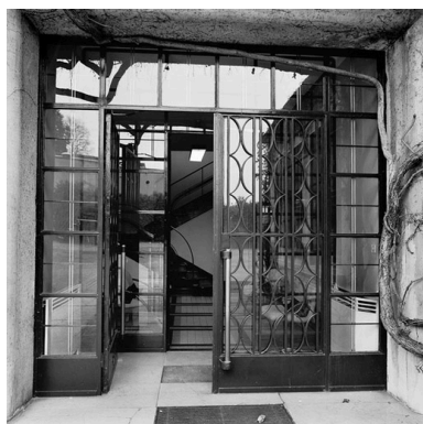
Porte d'entrée à deux ventaux avec décor géométrique : grille en ferronnerie Phot. Didier Gourbin IVR82_20043800033X
