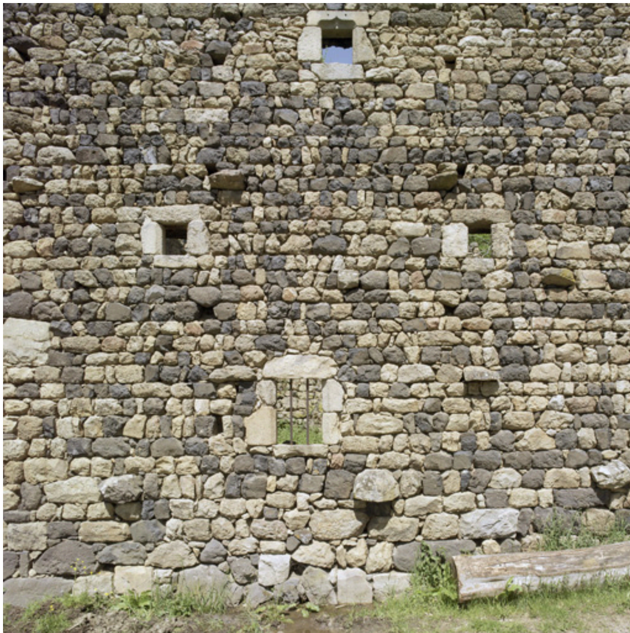
Bâtiments agricoles en ruine : mur pignon avec remplis, détail des matériaux (1986 AL 220).
