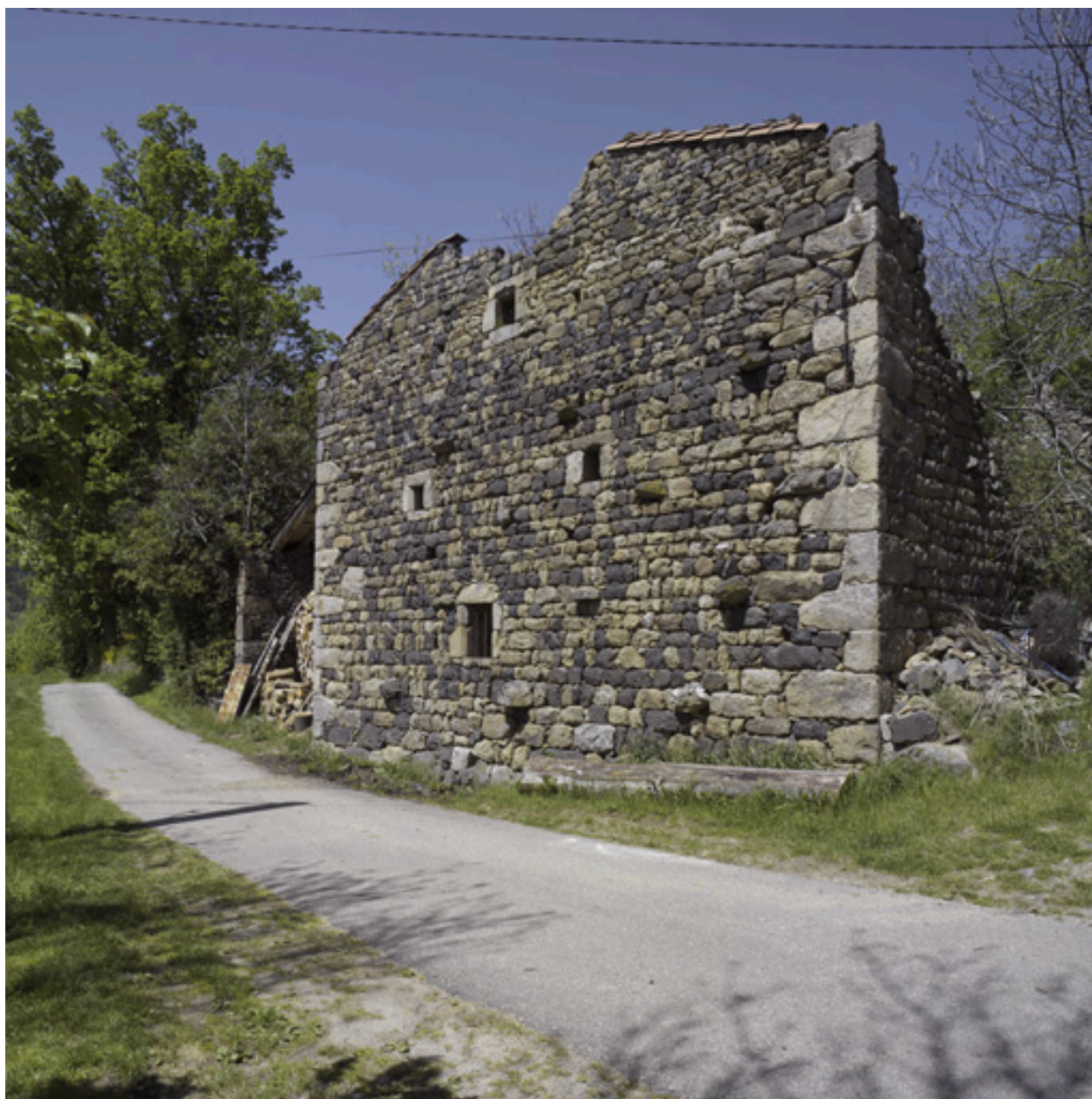
Bâtiments agricoles en ruine : mur pignon avec remplis (1986 AL 220).
