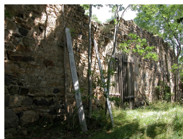
Bâtiments agricoles en ruine : grange (1986 AL 220). Phot. Caroline Guibaud IVR82_20124201096NUCA
