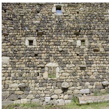
Bâtiments agricoles en ruine : mur pignon avec remplois, détail des matériaux (1986 AL 220). Phot. Eric Dessert IVR82_20084201251NUCA
