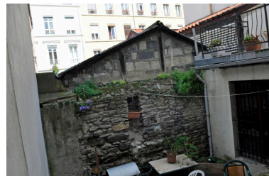
Vue de la cour, dont la partie nord est couverte en terrasse Phot. Catherine Guégan IVR84_20166900704NUCA
