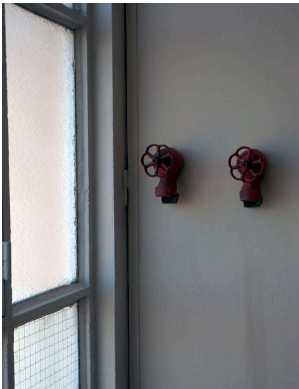
Prises de colonne sèche, repos de l'escalier
