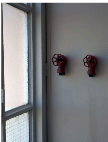
Prises de colonne sèche, repos de l'escalier Phot. Maryannick Chalabi IVR82_20106905075NUCA
