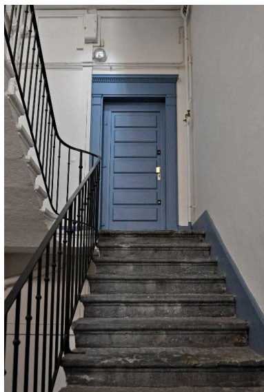
Vue intérieure, porte du premier palier : encadrement de menuiserie ancien Phot. Catherine Guégan IVR84_20176901353NUCA
