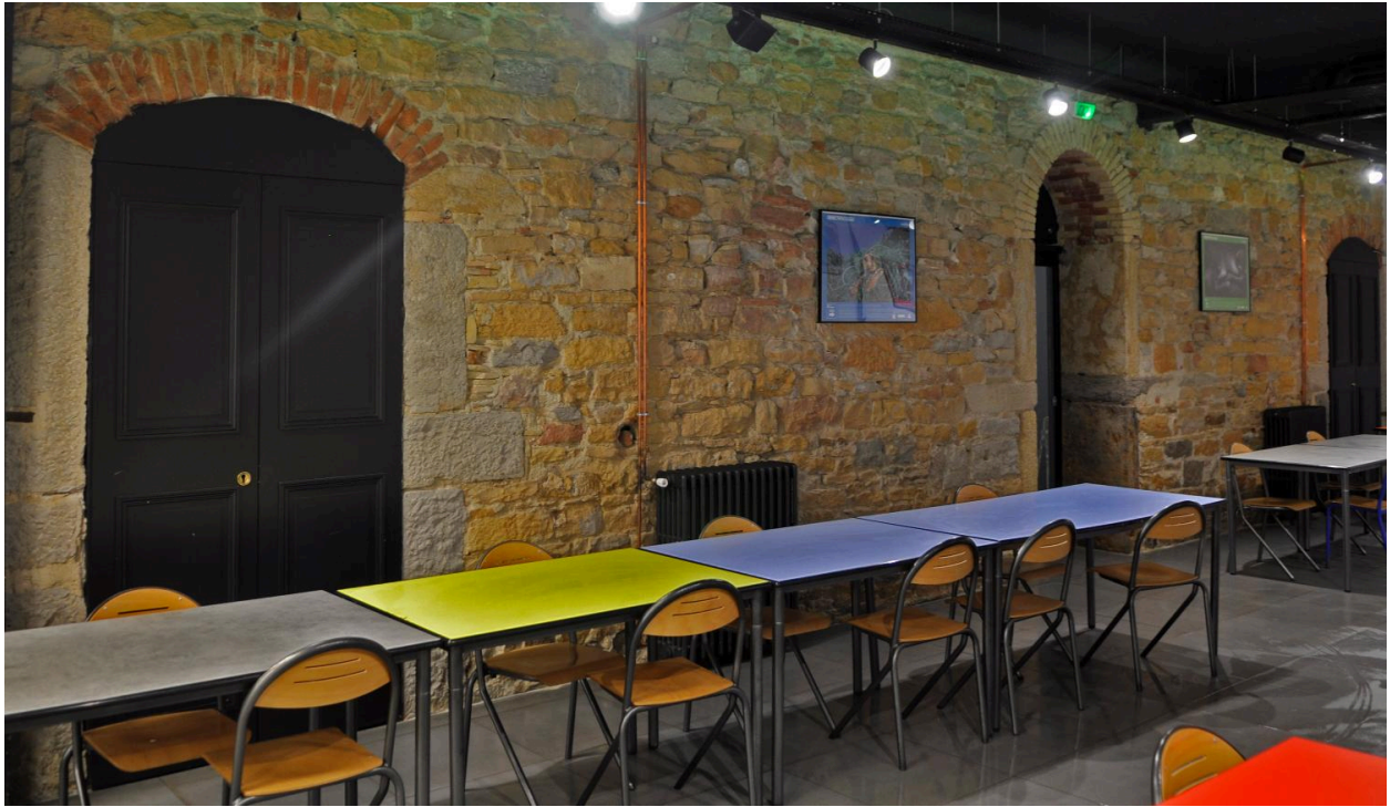
Bâtiment sur cour, élévation antérieure, mur construit en moellons de calcaire doré et encadrements brique
