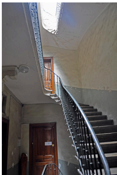
Bâtiment sur cour, escalier en milieu de bâtiment, à éclairage zénithal Phot. Magali Delavenne IVR84_20216901104NUCA
