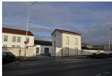
Site au moment de la démolition de la partie Givaudan-France en 2011 Phot. Nadine Halitim-Dubois IVR82_20116900436NUCA
