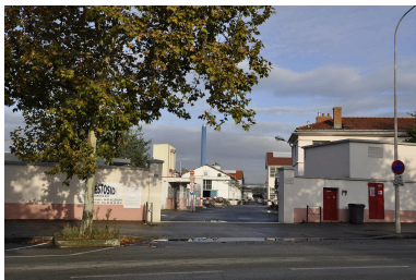
Site au moment de la démolition de la partie Givaudan-France en 2011 Phot. Nadine Halitim-Dubois IVR82_20116900432NUCA
