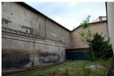
Cour fermée par la chapelle et la maison Phot. Véronique Belle IVR82_20096900789NUCA
