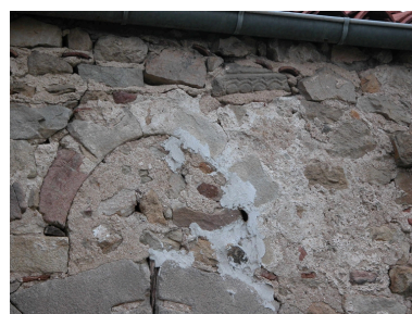
Détail des vestiges de l'ancienne fenêtre de la chapelle des Chabeu. Phot. Caroline Guibaud IVR82_20114200022NUCA
