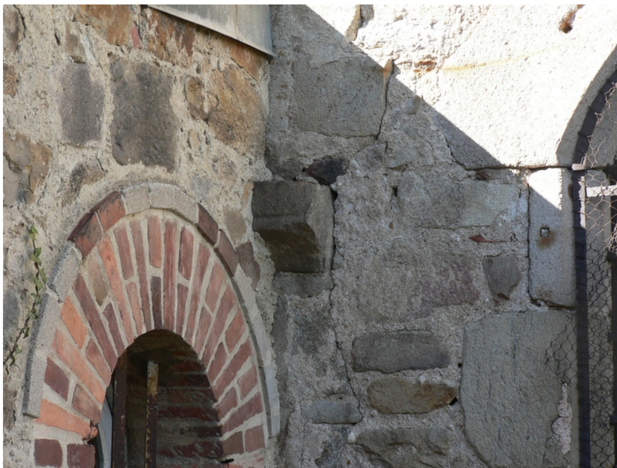
Détail d'un corbeau dans le mur de la chapelle des Chabeu (chapelle sud-est), à l'angle du mur de la sacristie.
