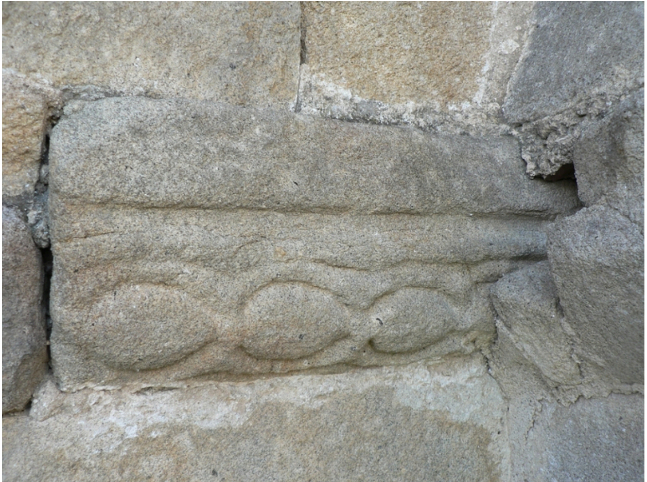
Détail du larmier du contrefort sud-est de la travée IV (à l'angle avec la travée de chœur).
