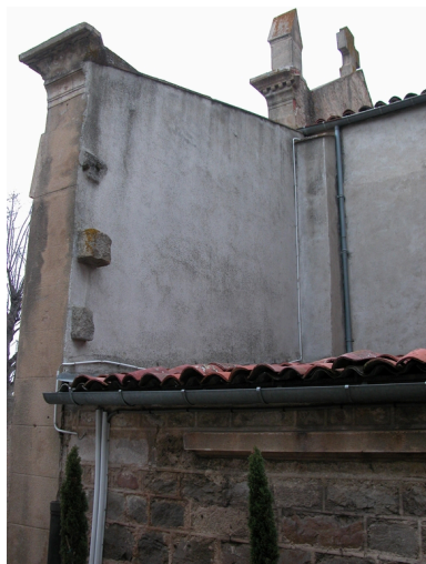
Vue arrière de la façade occidentale (partie sud, mur au-dessus de la chapelle Saint-Vincent, au sud-ouest). Phot. Caroline Guibaud IVR82_20114200021NUCA
