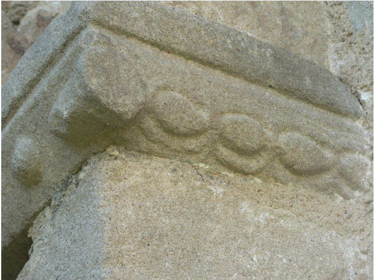
Détail du larmier du contrefort sud de la travée de choeur (angle avec la travée VI).
