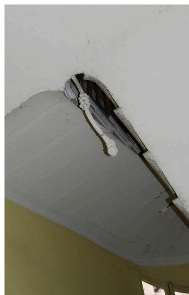
Détail d'un bec de gaz, sur le palier de l'escalier Phot. Catherine Guégan IVR84_20166900583NUCA
