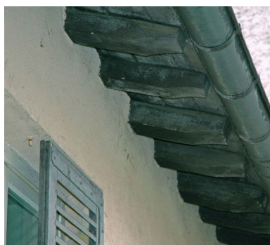
Solives de l'avant-toit sur cour, vues depuis la baie de la cage d'escalier au sud Phot. Maryannick Chalabi IVR82_20066901263NUCA
